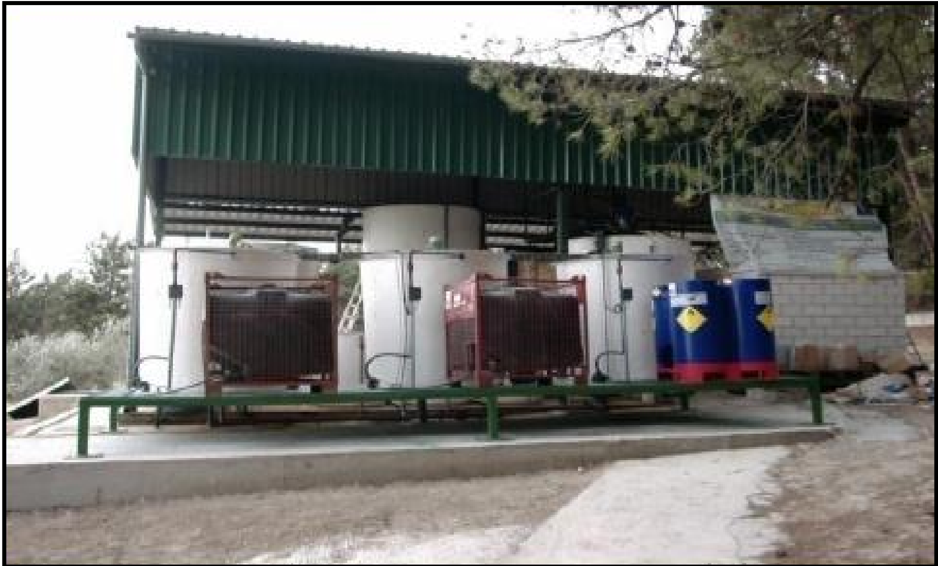
Planta semi-industrial situada en Baeza (Jaén) para la depuración de aguas residuales de la producción de aceite de oliva y del lavado de la aceituna mediante proceso Fenton.
